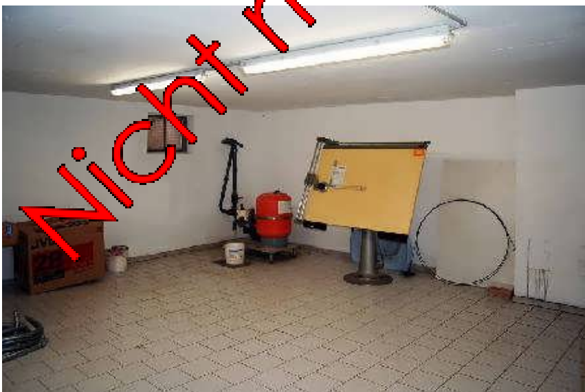
Keller mit Swimmingpoolpumpe
